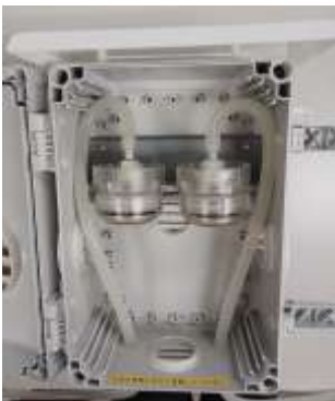
フィルタパック設置状態
