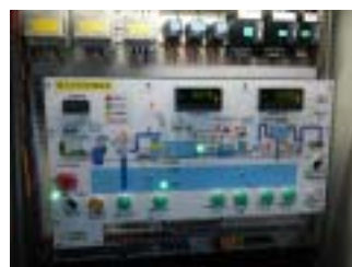
排水処理装置制御盤
